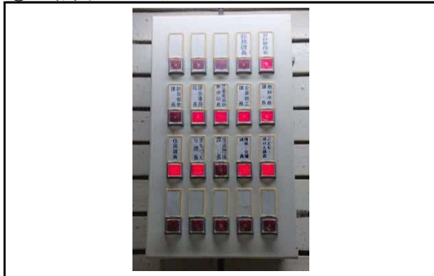
⑬ 職員出入口(入力盤)
