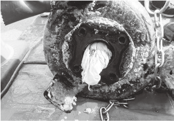
ポンプに詰まっている状態
